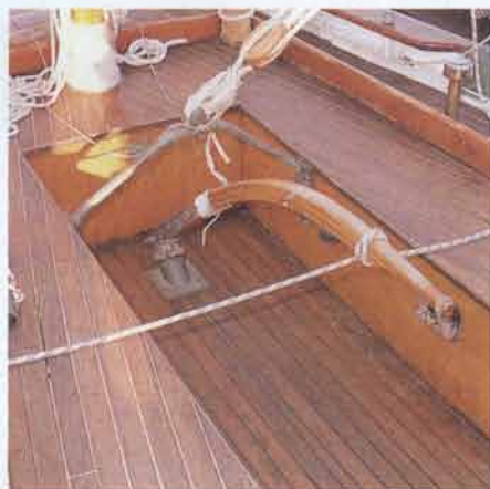
Die Nähte im Teakdeck des neu aufgebauten Cockpits wurden wie früher weiß vergossen.
